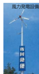
風力発電設備
